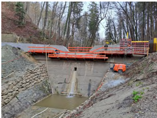
Abbildung 1: Dank des erhöhten Querbauwerks kann das angegliederte Rückhaltebecken mehr Wasser aufnehmen als bisher. Eine neu eingerichtete Abflussrinne sorgt nun für einen kontrollierten Abfluss des Wassers ins Becken unterhalb. Foto: Wasserwirtschaftsamt Traunstein
