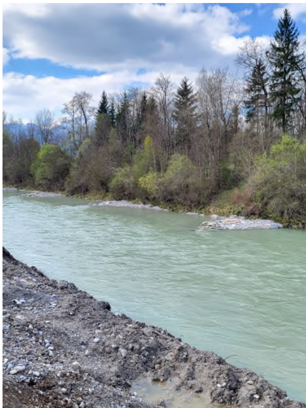
Abbildung 1: Einige der auf bayerischer Seite geplanten, 40 Buhnen sind bereits angelegt. Sie sorgen dafür, dass sich Geröll, Totholz und anderes Geschiebe weniger gut im Fluss ablagern können. In der Folge wird sich die Gewässersohle weniger stark anheben. Das Wasser wird weniger hoch ansteigen und weniger rasch über das Ufer treten. Foto: Wasserwirtschaftsamt Traunstein
