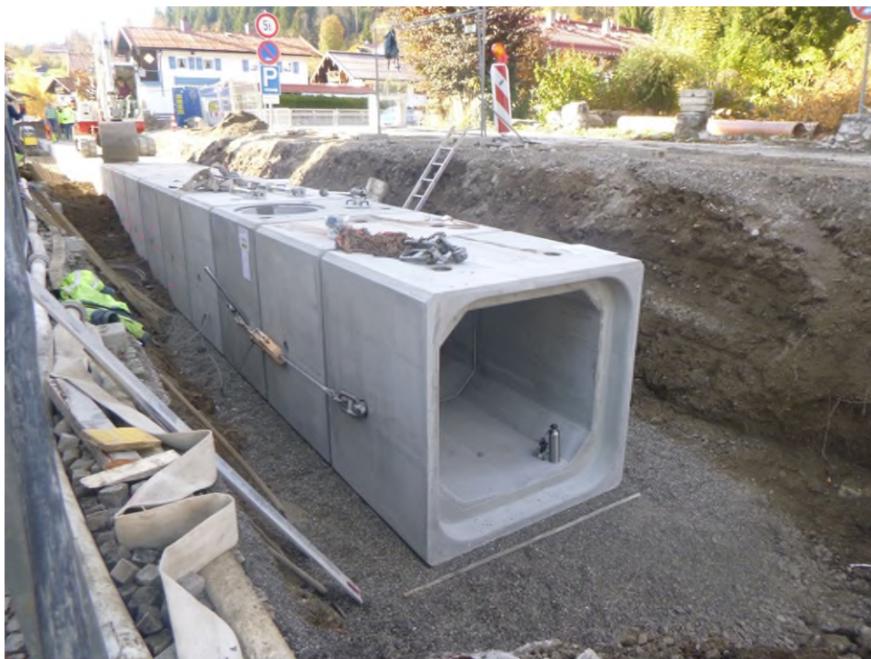
Abb. 2: Der neu verlegte Hochwasserkanal ist wesentlich leistungsstärker. Er besteht aus Beton-Fertigteilen, die ineinander gesetzt werden. Foto: Wasserwirtschaftsamt Traunstein
