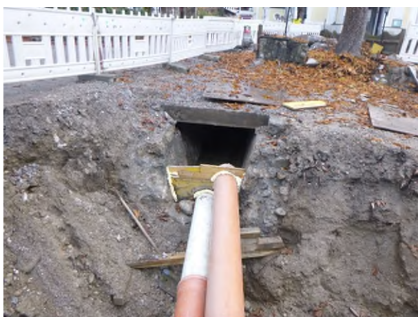
Abb. 1: Viel zu klein und damit nicht leistungsstark war der Hochwasserkanal, der bisher das Hochwasser am Hausbach in Reit im Winkl abtransportiert hat. Foto: Wasserwirtschaftsamt Traunstein
