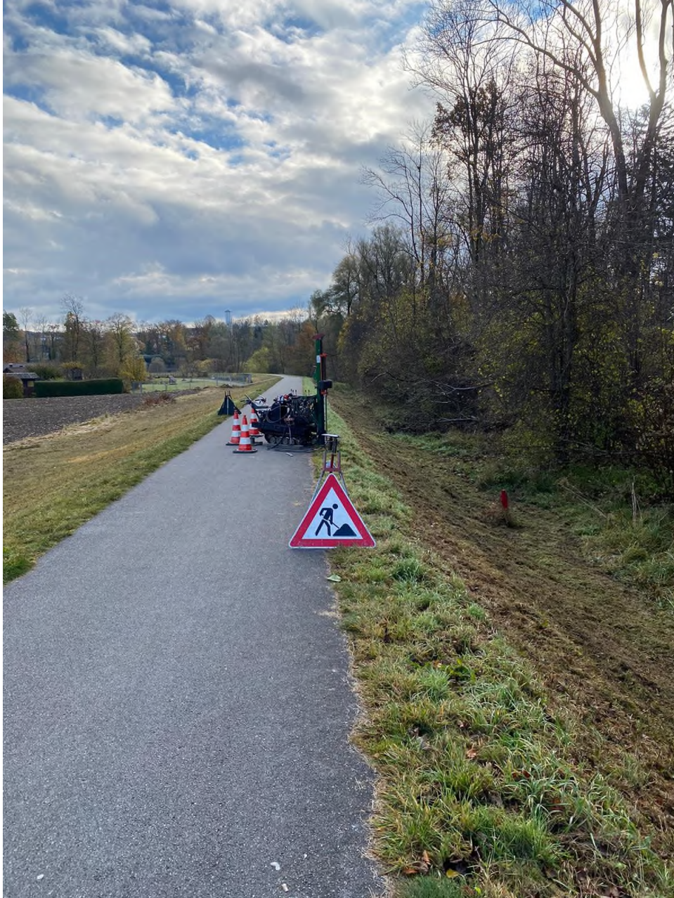
Mit einem Sondierungsgerät wird untersucht, aus welchen Materialien sich der Deichaufbau zusammensetzt. Foto: Crystal Geotechnik GmbH
