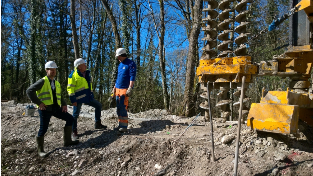
Abb. 1: Emmertings Bürgermeister Stefan Kammergruber, Walter Raith Behördenleiter WWA TS, Martin Zweck Firma Bauer;
