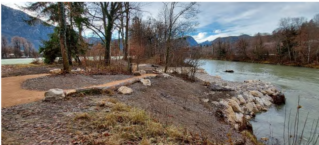
Bildunterschrift: Nah ans Wasser gebaut: Der Zugang zur Saalach in Bad Reichenhall ist fertiggestellt. Foto: Wasserwirtschaftsamt Traunstein
